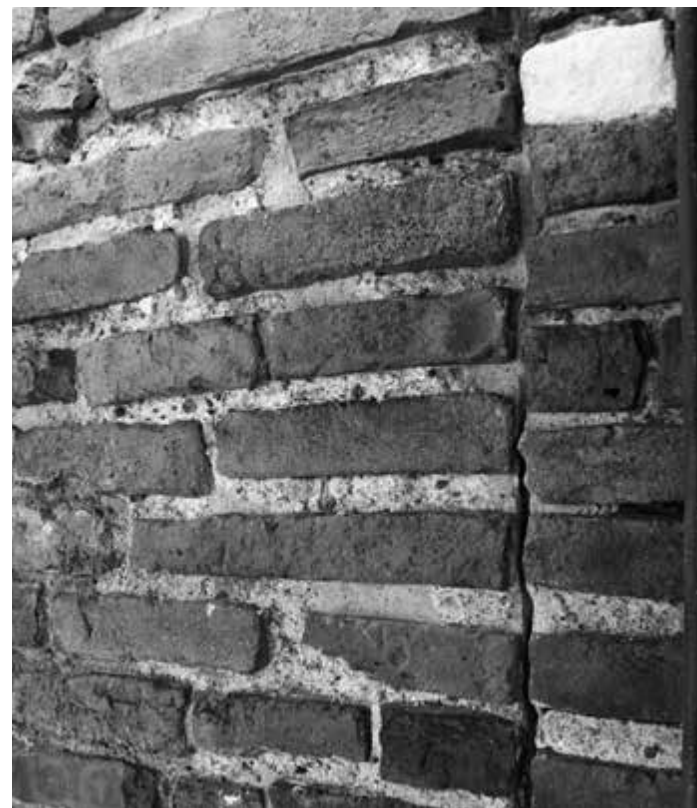
13. Giunto rettilineo tra l'ala di raccordo del tetraconco (a sinistra) e il perimetrale dell'atrio di Sant'Aquilino (a destra); fronte occidentale alla quota dei finestroni
