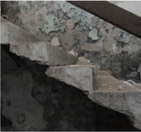
5: Materiali e peculiarità costruttive: un raro esempio di scala con gradini a sbalzo della lunghezza di circa 150 centimetri in arenaria.
