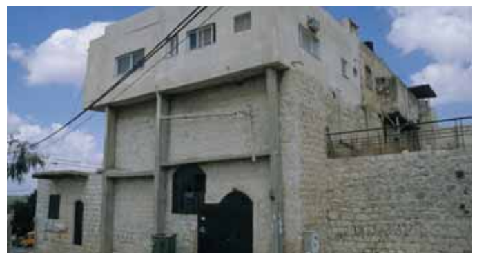
Les opérations d'addition de nouveaux volumes ne peuvent pas finir par être une charge pour le bâtiment préexistant. Deir Estia (Palestine)
