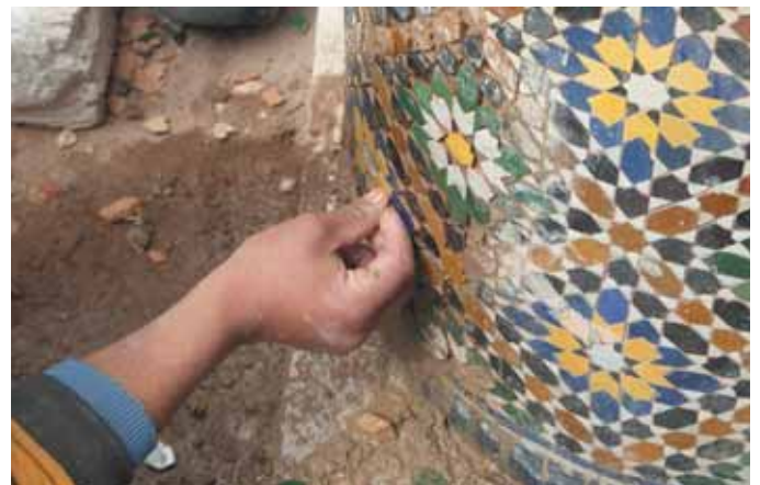
La formation d'une main-d'œuvre spécialisée est importante pour garantir une réhabilitation de qualité. / Dar el Bacha, Marrakech
