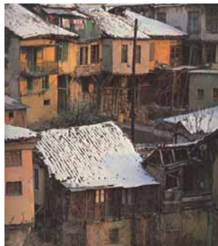
3. Le manque d'entretien est un facteur qui endommage le patrimoine.
