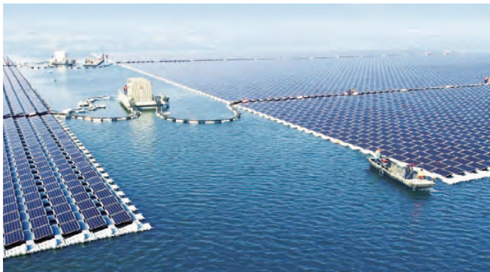
Figura 4. Pannelli fotovoltaici off-shore
