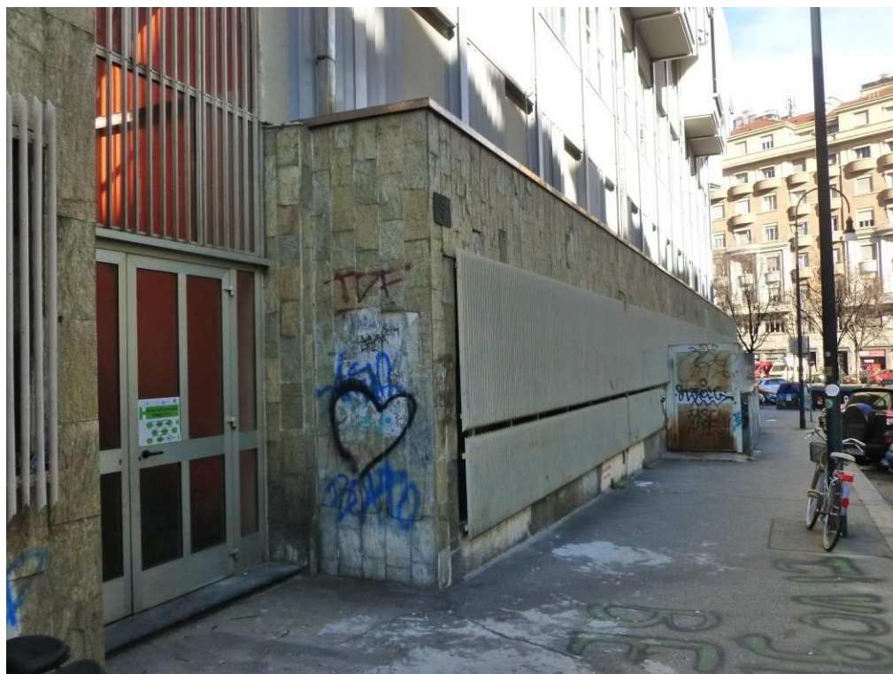
Fig. 13 - Ingresso ex Biblioteca Patetta (attualmente Master in Giornalismo) su via Roero di Cortanze
