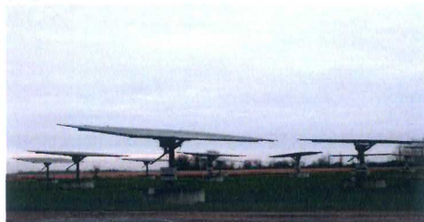
Fig. 1A Fotovoltaico a terra. Comune Ronsecco (VC)
