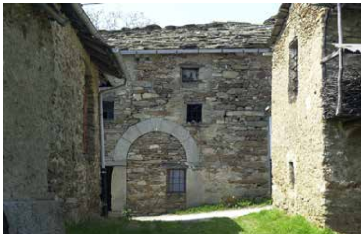
FIGURA 8: I palinsesti delle tessiture murarie, tracce materiali lasciate da chi ci ha preceduto. Edifici polifunzionali aggregati di Borgiallo, Frassinetto, Prealpi canavesane.
