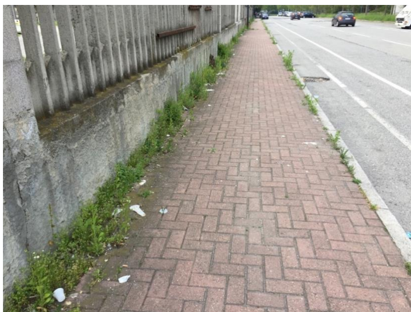
Figura 5. Marciapiede con vegetazione sviluppatasi nello spigolo fra marciapiede e muro adiacente (striscia inerbita a sinistra) e lungo la linea di giunzione fra piano di calpestio e cordolo (Torino. 45.0517° N, 7.5825° E. Foto F. Vidotto).
