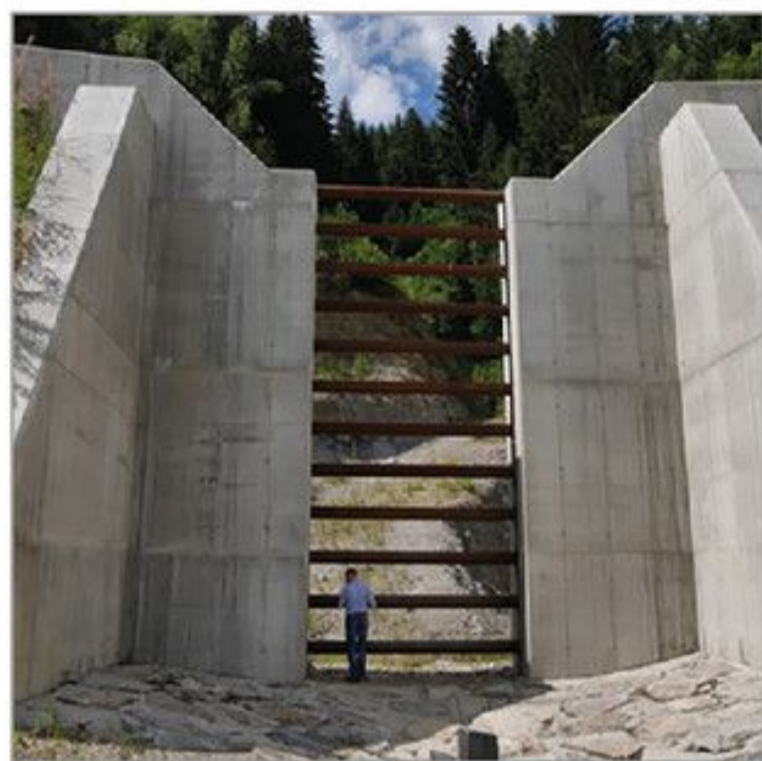
Esempio di misura tecnica artificiale volta all'arresto di lave torrentizie (Eurac research ® ).
