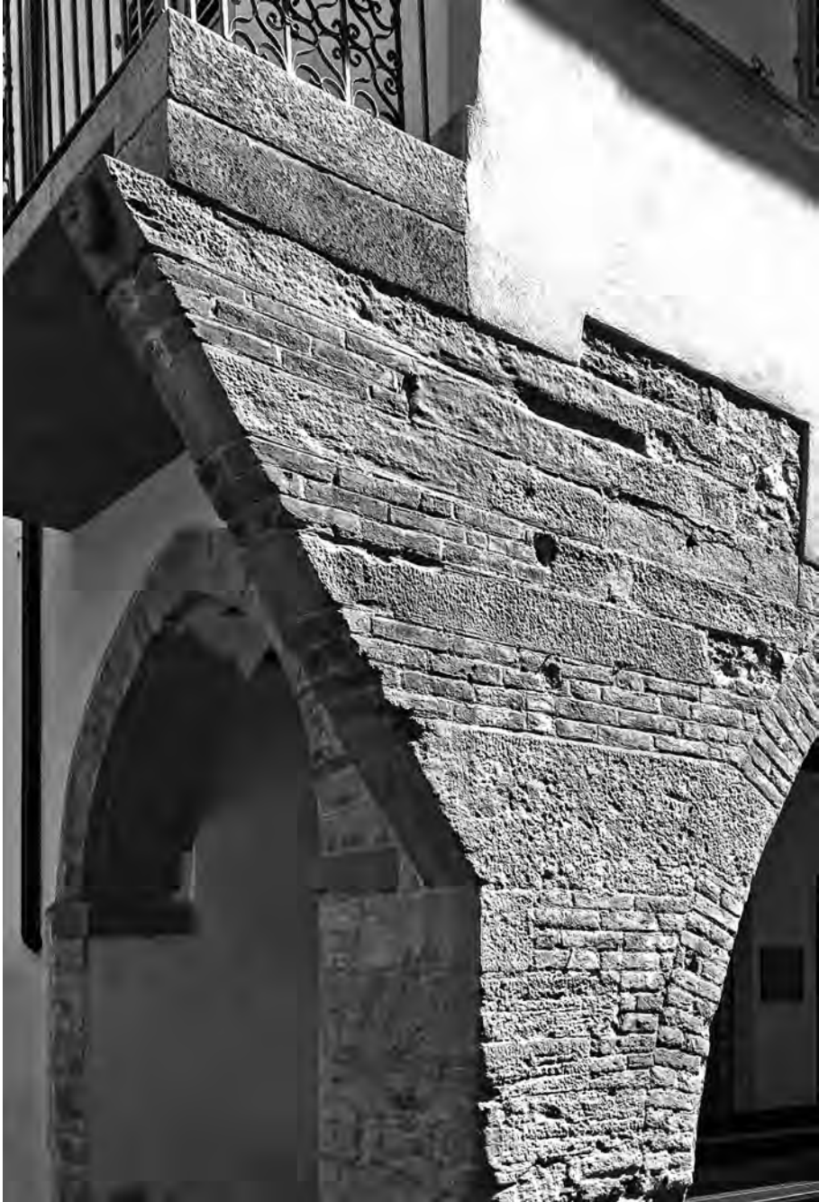
Fig. 3 - Ceva. Mensola in muratura mista di mattoni e pietra che sorreggeva le strutture a spunto del primo piano e superiori di un edificio in via Carlo Marengo (foto E. Lusso).
