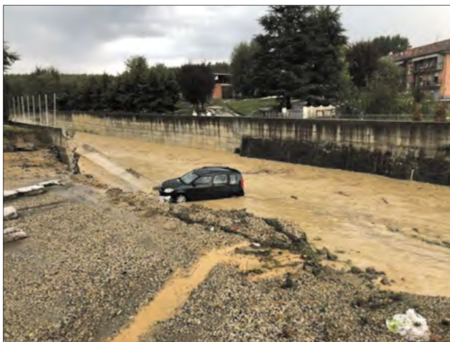
Figura 10. Il muro crollato appena a monte della sezione 1 a seguito dell'evento meteorologico del 5 settembre 2019 (Rif: WEB n. 4)
