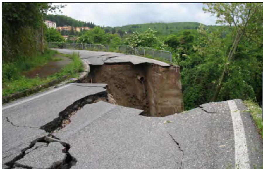
Figura 1. Frana sulla S.P. per San Vito Romano (RM)
