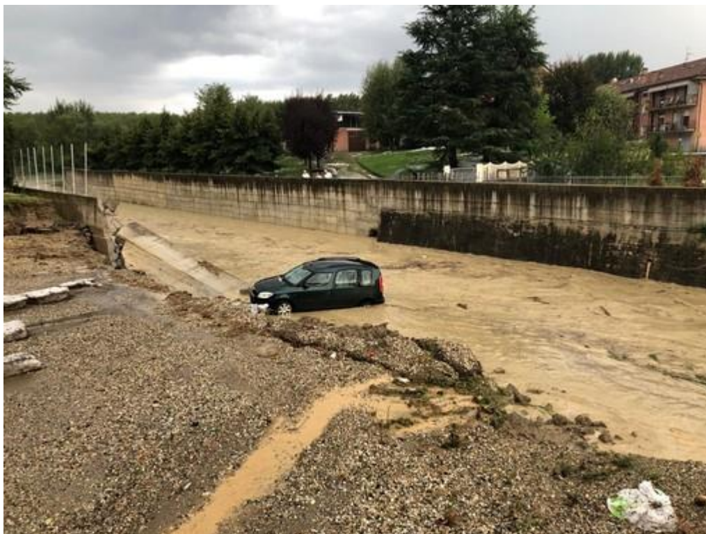
Figura 10 - Il muro crollato appena a monte della sezione 1 a seguito dell'evento meteorologico del 5 settembre 2019 (Rif. WEB n. 3).
