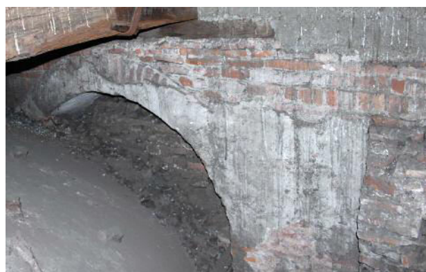
Fig. 11. Resti di intonaco sulla ghiera di una finestra paleocristiana del perimetrale nord della basilica.
