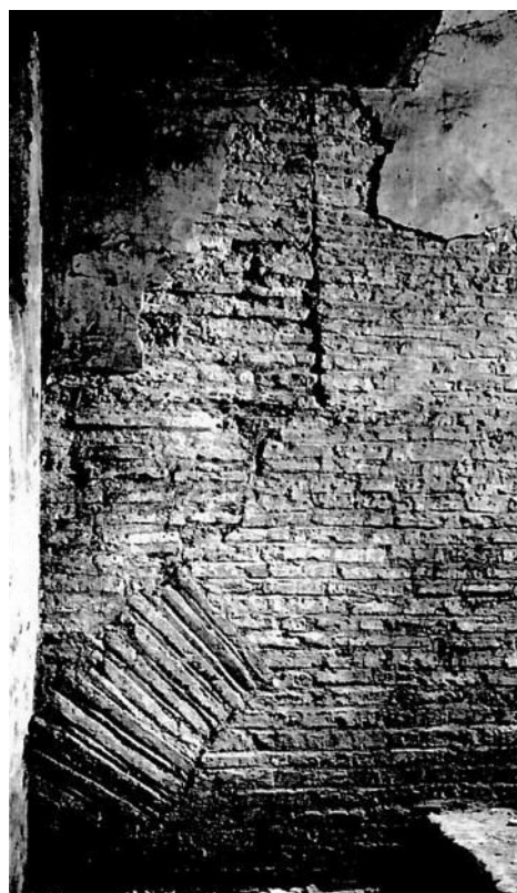
Fig. 7. Perimetrale nord, ghiera di finestra con doppia lisciatura dei giunti, S. Giovanni al Laterano (da APOLLONJ GHETTI 2013).
