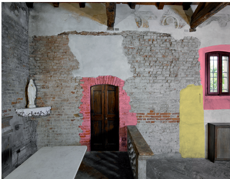
Muro perimetrale meridionale, 2012. Nosedo, chiesa dei Santi Giacomo e Filippo. In rosso sono segnalate la finestra e la porta della sacrestia moderne, in giallo il tamponamento di una porta più antica
