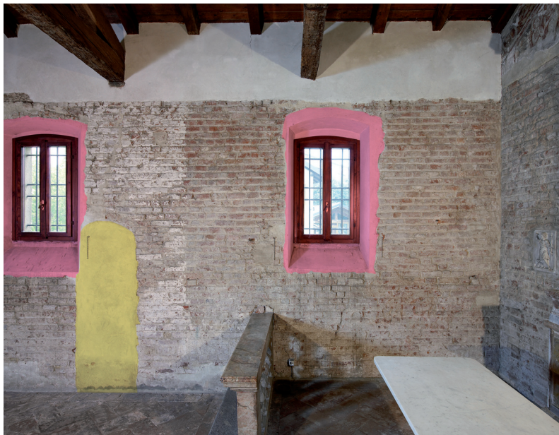
Muro perimetrale settentrionale, 2012. Nosedo, chiesa dei Santi Giacomo e Filippo. In rosso sono segnalate le finestre moderne, in giallo il tamponamento di una porta più antica
