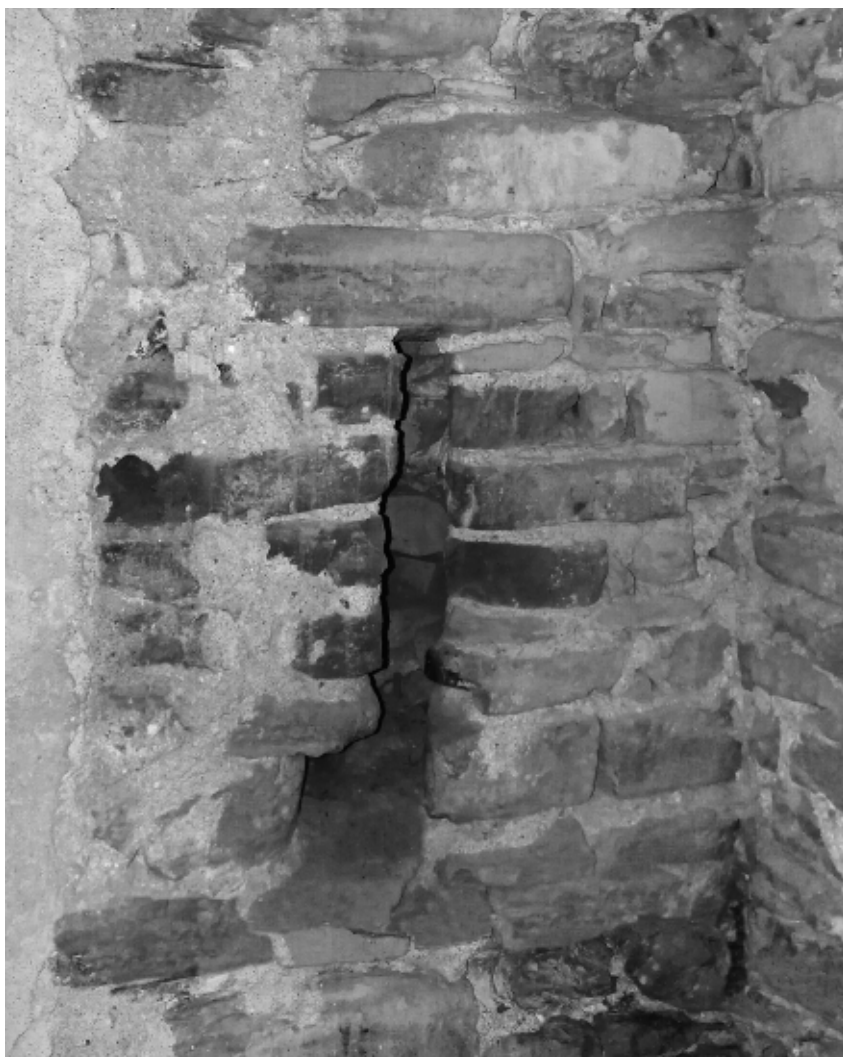
Fig. 3 - Rocca Ciglié, parrocchiale di Santa Maria Assunta. Campanile, interno; feritoia tamponata che si apriva in un tratto già parte dell'antico perimetro murario di cinta dell'abitato (fotografia dell'autore).
