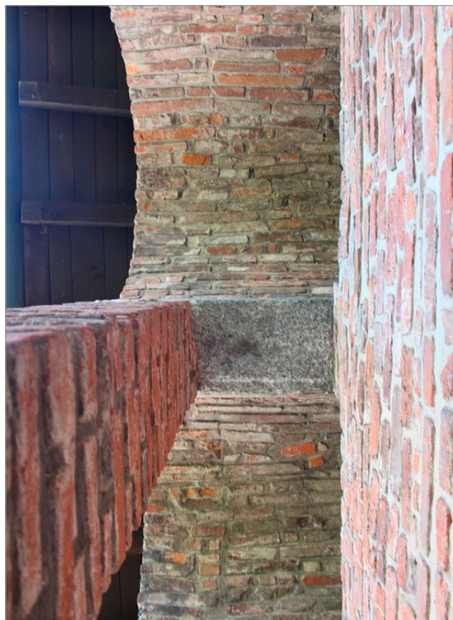
fig. 14 – a) Tecnica costruttiva del muro di fondo del loggiato; b) Sezione del loggiato dai lavori di G. Chierici (Archivio SABAP per la Città Metropolitana di Milano); c) Tecnica e materiali da costruzione delle volte a botte del loggiato.
