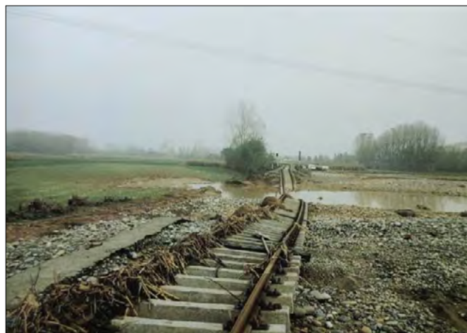
FIGURA 4 - Ripresa lungo la ferrovia canavese. Evidenti i danni causati dalle acque di esondazione del T. Malone straripate in destra idrografica a monte dell'abitato di S. Benigno (Regione Piemonte, 1998).
