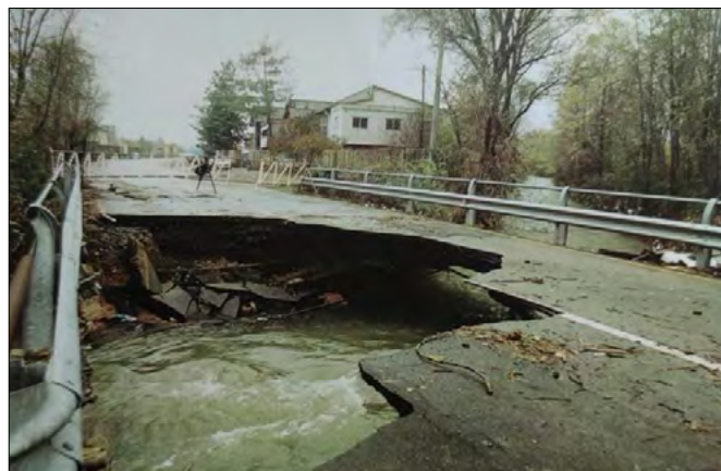
FIGURA 3 - Comune di Volpiano. Ripresa da Est dell'attraversamento sul T. Bendola, lungo la strada statale tra Volpiano e Leini, gravemente danneggiato dalle acque di piena del torrente (Regione Piemonte, 1998).
